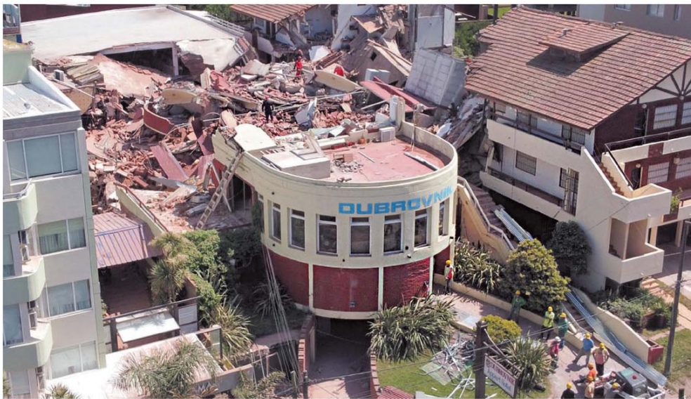
El edificio del apart hotel se desmoronó sobre construcciones linderas
